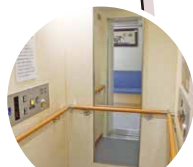
エレベーター
